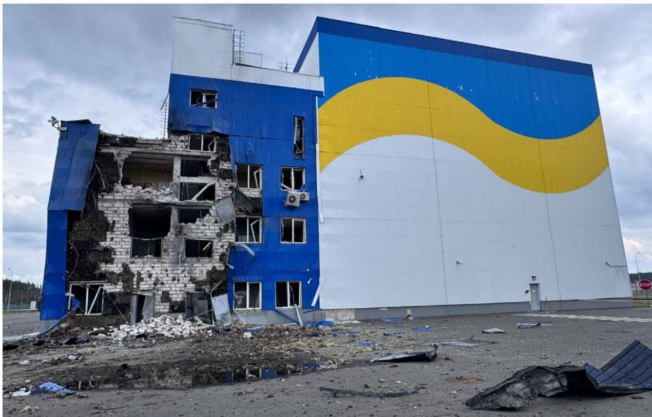
Поврежденное здание Центрального хранилища отработавшего ядерного топлива.
